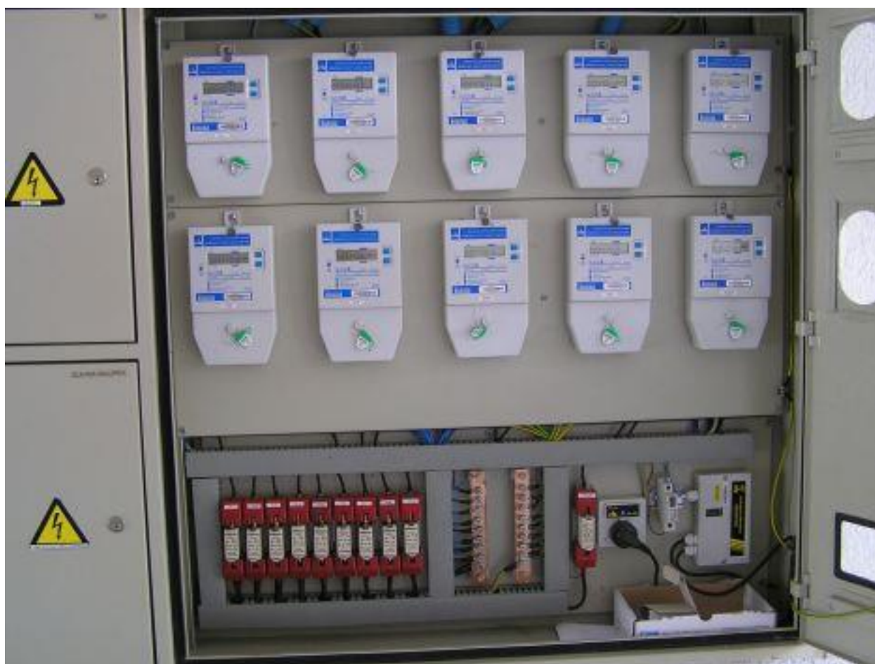
Slika 5.3 Tipična RIZ AMR instalacija u zgradi [17]
