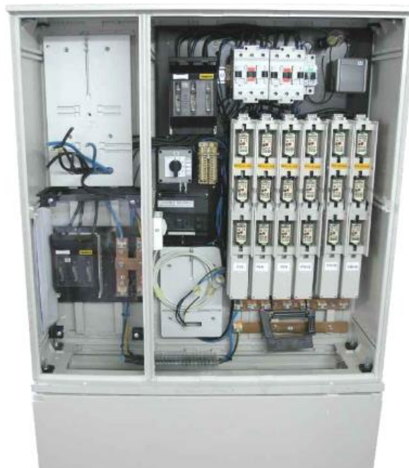
Slika 3.8. Slobodnostojeći razvodni ormar javne rasvjete [11]
