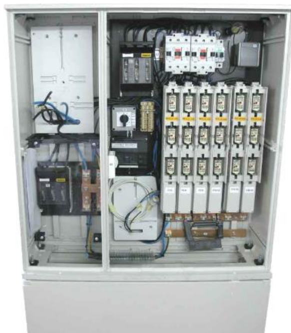
Slika 3.8. Slobodnostojeći razvodni ormar javne rasvjete [11]
