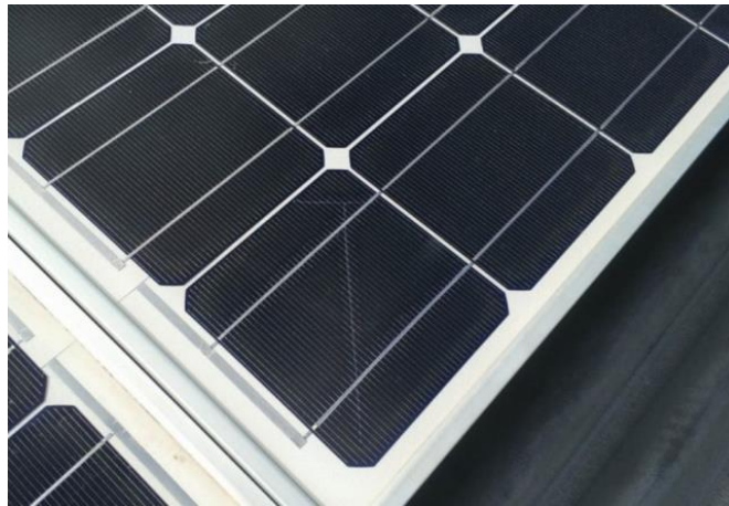
Slika 4.3.2.6 Pukotina u ćeliji, izvor [24]
