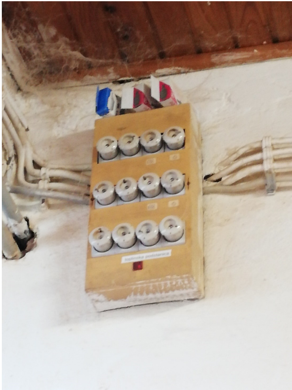
Slika 5.1. Razvodni ormar (fotografirano 3.6.2019.).
