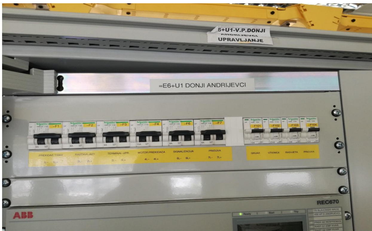
Slika 5.11. Istosmjerni i izmjenični automatski osigurači u ormaru upravljanja E6+U1
