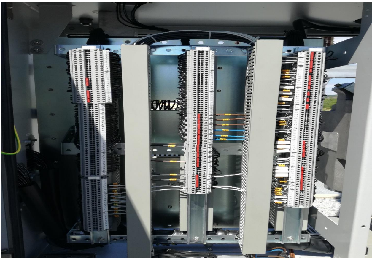
Slika 5.13. Redne stezaljke u ormaru prekidača
