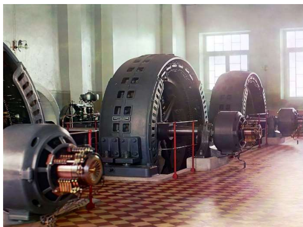
Slika 3.1 Električni generator u hidroelektrani [4]
