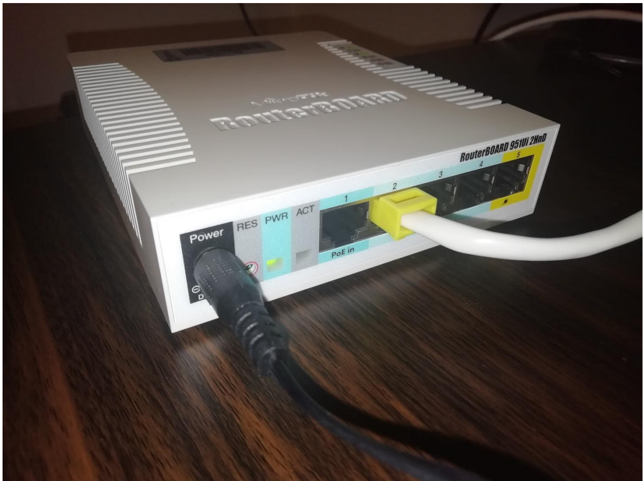
Slika 5.1. Ethernet kabl uključen u port 2 usmjerivača
