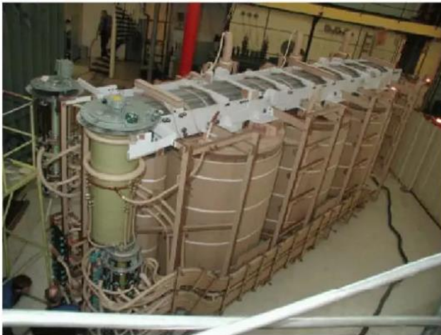
Slika 3.6. Trofazni autotransformator 400MVA, 400/231/10,5 kV [10].
