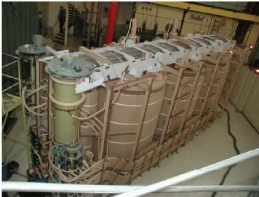
Slika 3.6. Trofazni autotransformator 400MVA, 400/231/10,5 kV [10].
