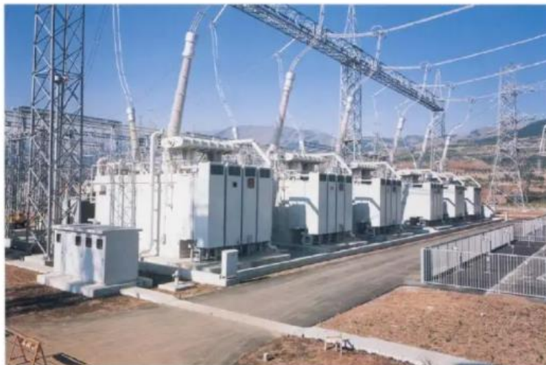
Slika 3.8. Jednofazni autotransformator 500 MVA [10].
