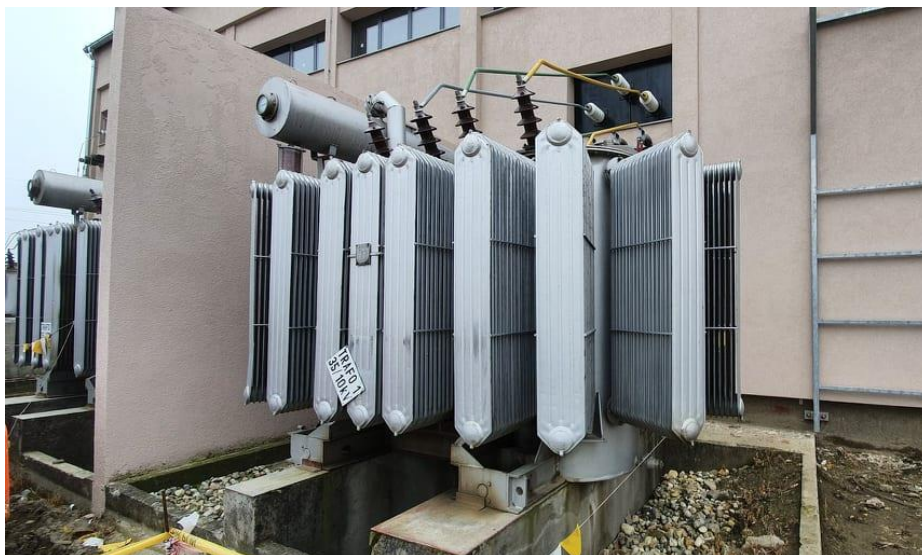
Slika 2.16. Distribucijski transformator 35/10 kV
