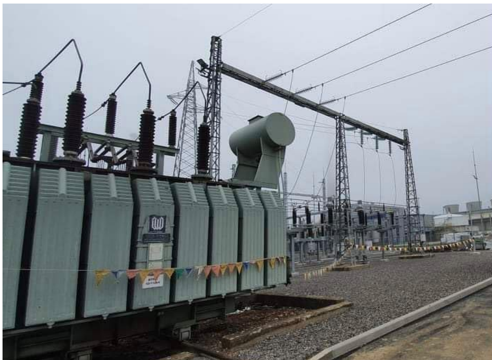
Slika 2.8. Transformator 10/110 kV i vodno polje
