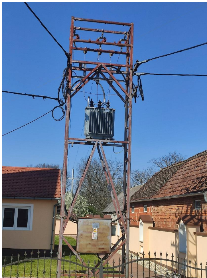
Slika 3.11. Stupna transformatorska stanica 20/0,4 kV
