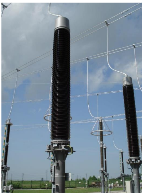
Slika 2.24. Uljni jednopolno izolirani naponski mjerni transformator [1]
