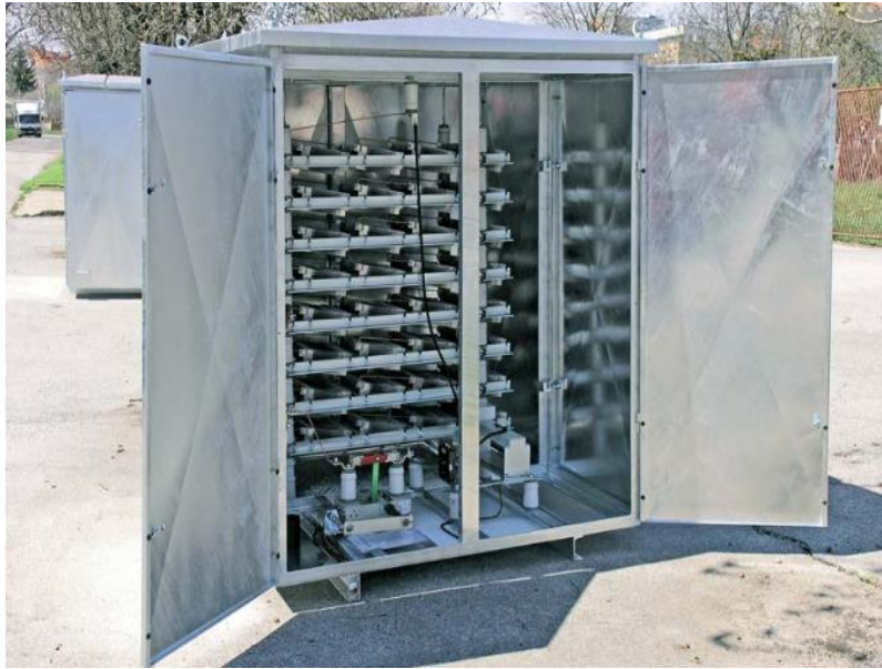
Slika 2.33. Unutrašnjost otpornika za uzemljenje zvjezdišta transformatora [9]
