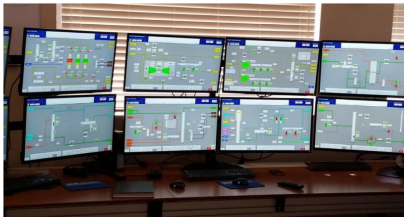
Sl. 4.17. Primjer kontrolne sobe.
