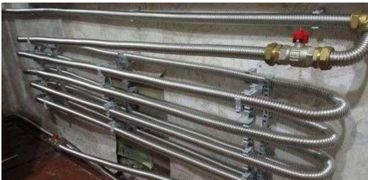
Slika 2.9. Valovita cijev od nehrđajućeg čelika u sustavu cjevovoda za potrebe grijanje, [15]
