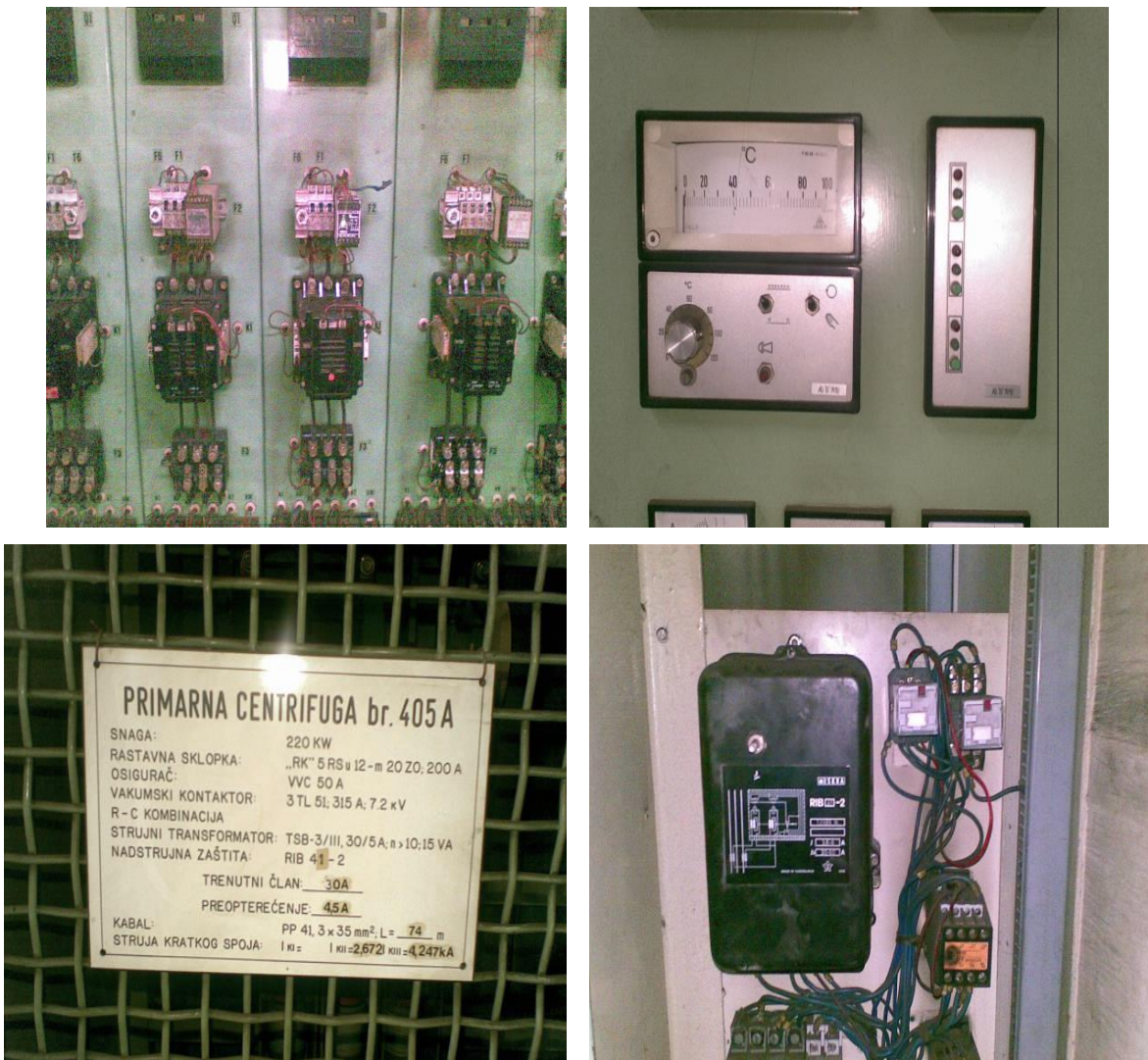
Slika 4.1. Prikaz 6 kV ćelije primarne centrifuge 220 kW i pripadajuće elektromehaničke zaštite kojom se štiti u Rudniku Banovići
