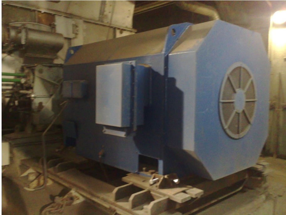
Slika 7.14. Motor mlina 6. snage 800 kW bloka 6. TE Tuzla
