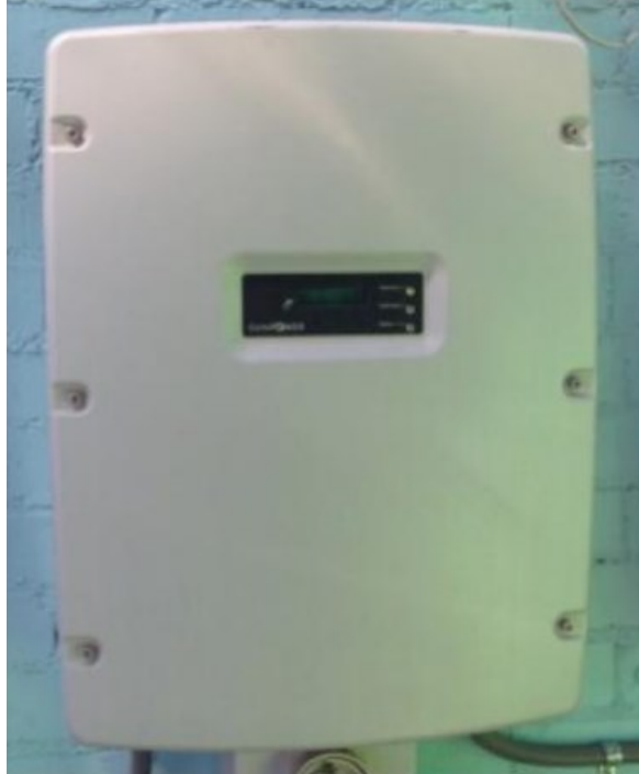
Slika 3.5. Izmjenjivač u fotonaponskom sustavu [11]
