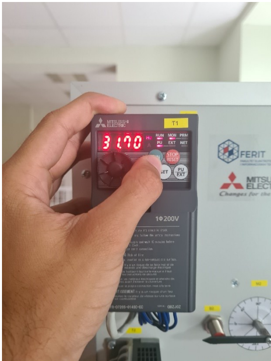
Sl. 4.12 Postavljanje željene frekvencije i pokretanje asinkronog motora
