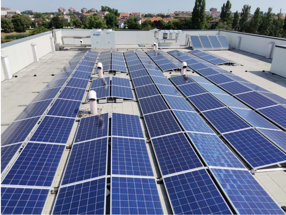
Slika 4.16. Fotonaponska elektrana na krovu zgrade
