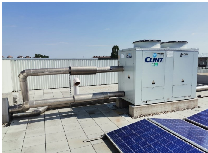
Slika 4.11. Rashladni uređaj hlađen vodom
