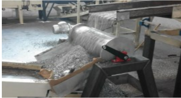
Slika 5.4. Valjkasti magnetski separator u postrojenju [13]
