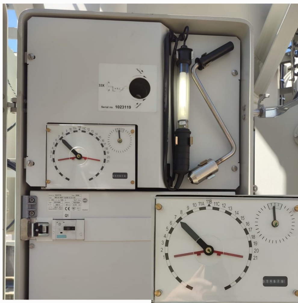
Slika 3.8. Prikaz položaja regulacije distributivnog transformatora s automatskom preklopkom (110/20/10 kV) nazivne snage 20000 kVA.
