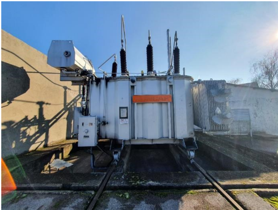
Slika 5.8. Transformator (fotografirano 24. studenog 2021.)
