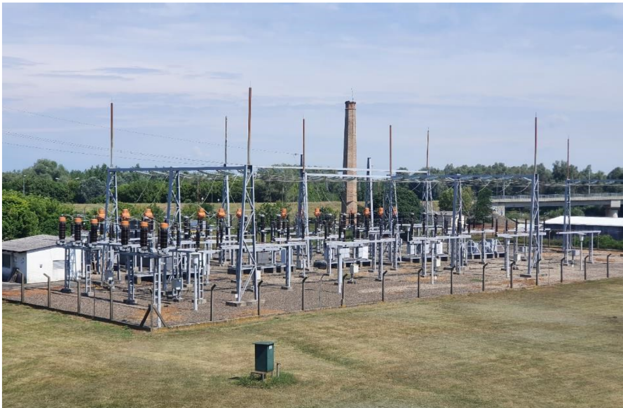
Slika 5.1. Transformatorska stanica TS 110/6,3 kV (fotografirano 7. srpnja 2022)
