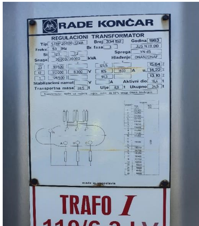
Slika 5.9. Natpisna pločica energetskog transformatora (fotografirano 13. travnja 2022.)
