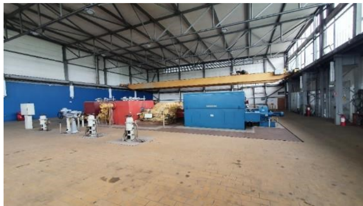
Slika 5.10. Generator 2 Siemens (fotografirano 9. kolovoza 2022.)
