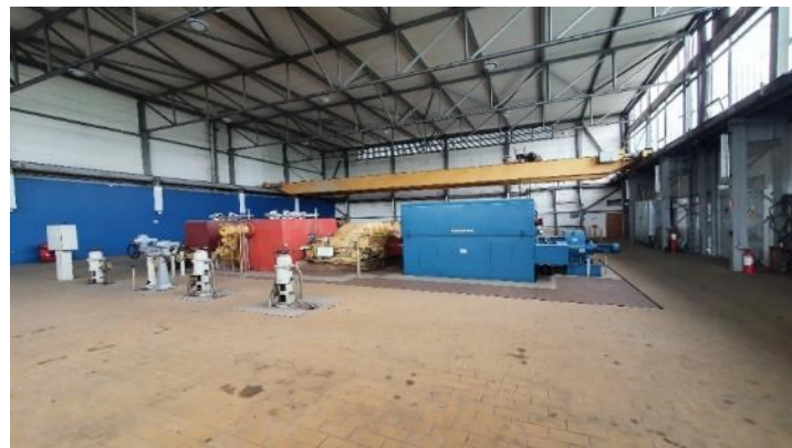
Slika 5.10. Generator 2 Siemens (fotografirano 9. kolovoza 2022.)
