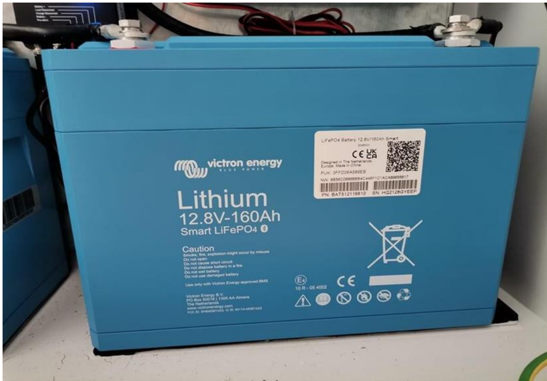
Slika 4.12. Victron Energy LiFePO baterija – 12.8 V, 160 Ah
