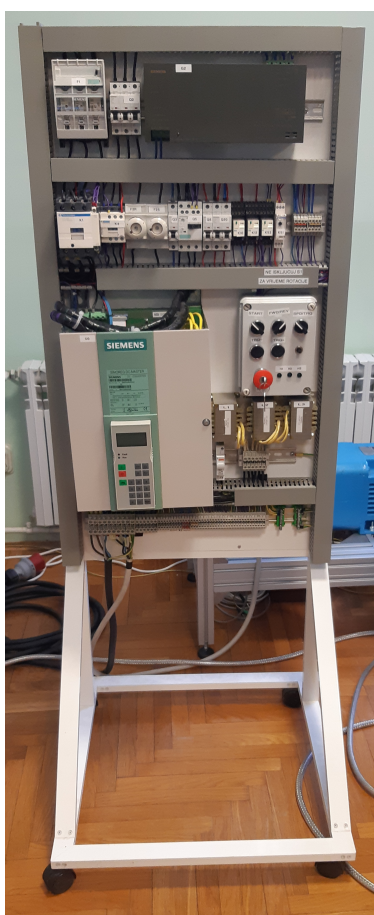
Slika 3.19: Pretvarač Siemens Simoreg za upravljanje momentom istosmjernog motora.
