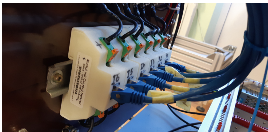
Slika 3.12: Smještaj strujnih sondi u postolju.
