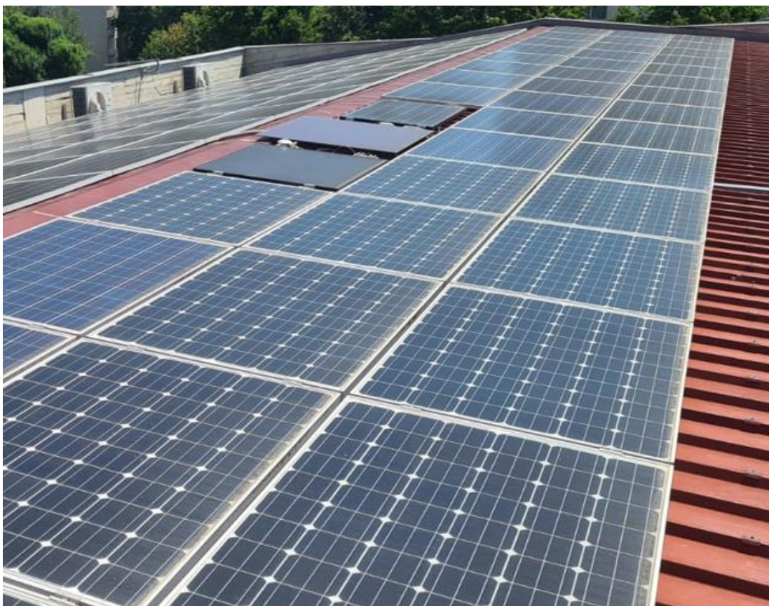
Slika 3.3 Prikaz fotonaponskih panela
