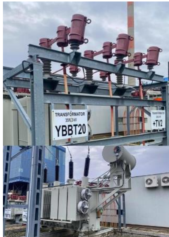
Slika 3.19. Prikaz transformatora 35/6,3 kV (fotografirano 10.siječnja 2023.)
