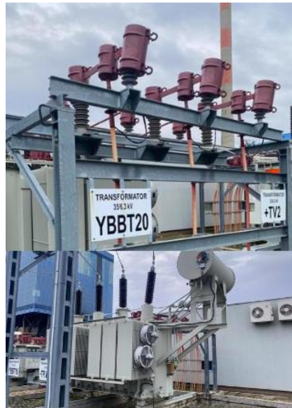
Slika 3.19. Prikaz transformatora 35/6,3 kV (fotografirano 10.siječnja 2023.)
