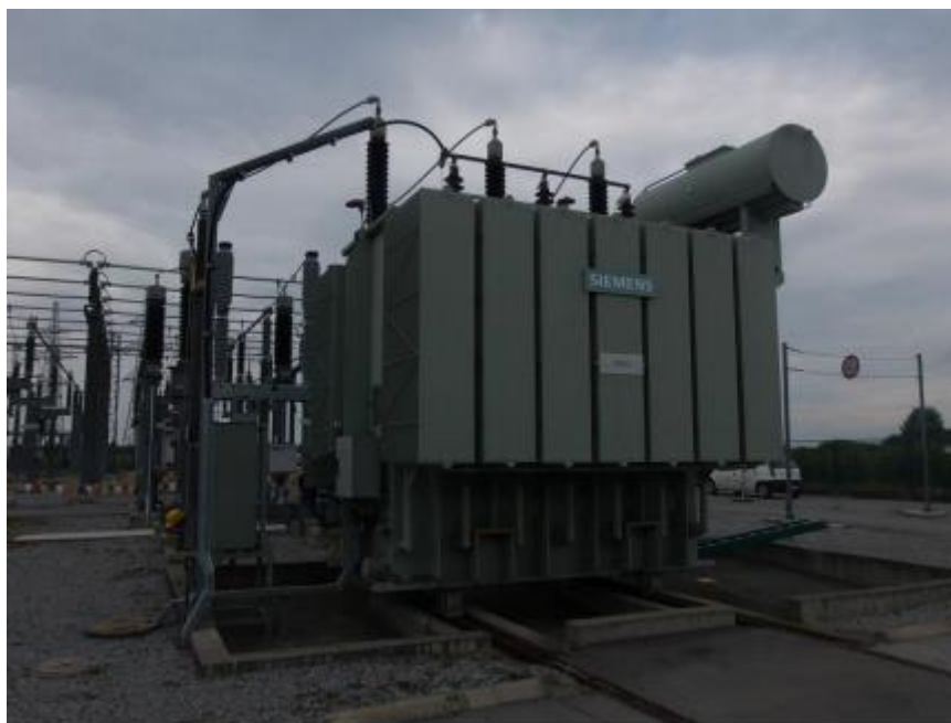
Slika 3.3.: Regulacijska prigušnica ugrađena na 110 kV sabirnice u TS 400/110 kV Ernestinovo[4]
