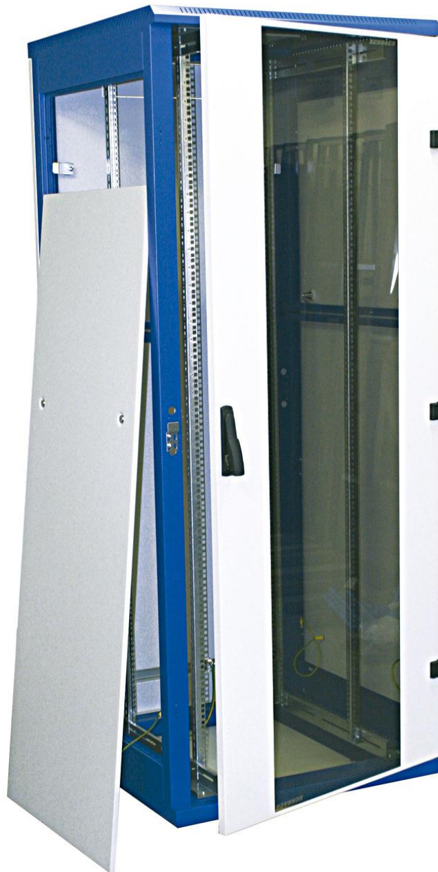
Slika 3.6 Glavni komunikacijski ormar
