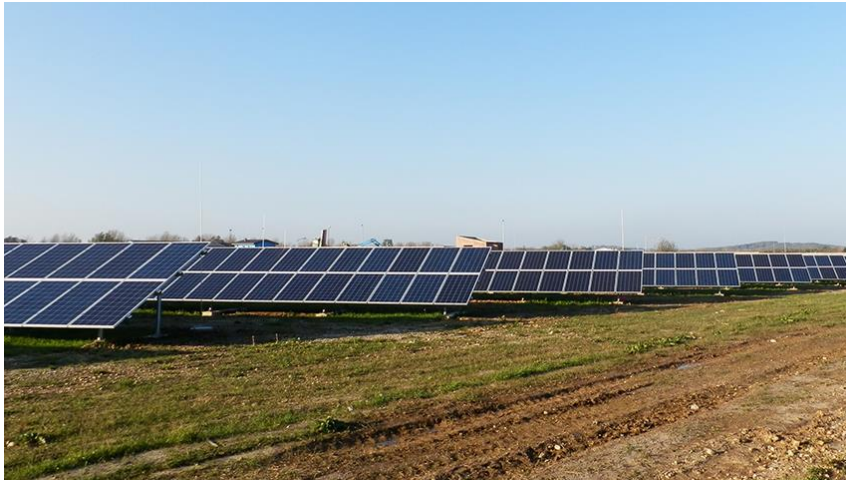
Sl.3.1. Sunčana elektrana BT Solar 1 [12]
