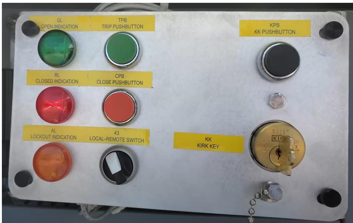
Sl. 4.2. Blokada kondenzatorskih baterija ključem [8]
