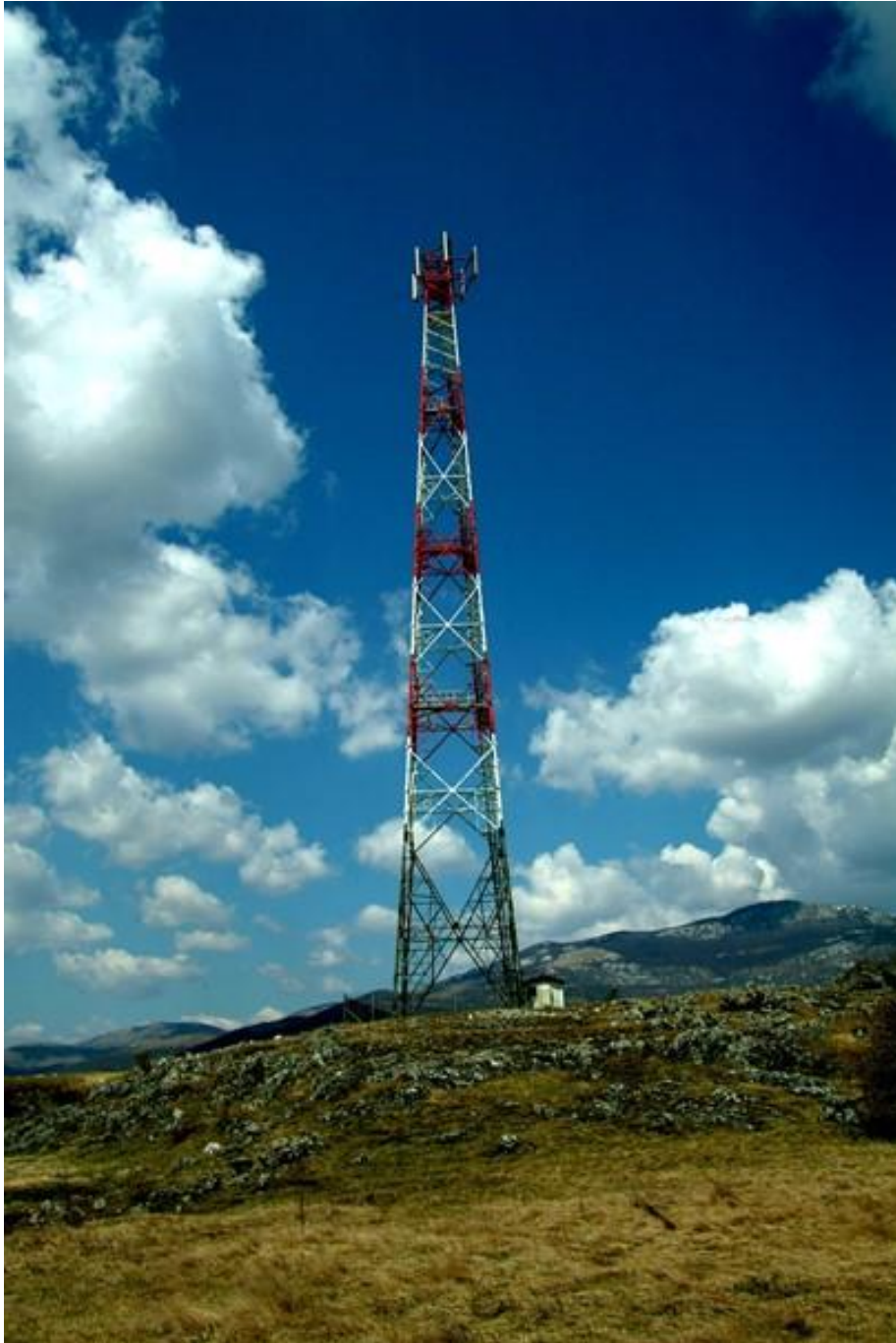
Slika 3.3. Rešetkasti antenski stup [9]
