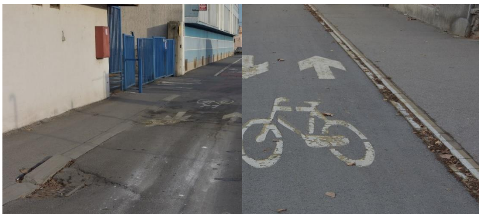
Slika 5.8. Oštećenja i razgraničenje pješačke i biciklističke staze
