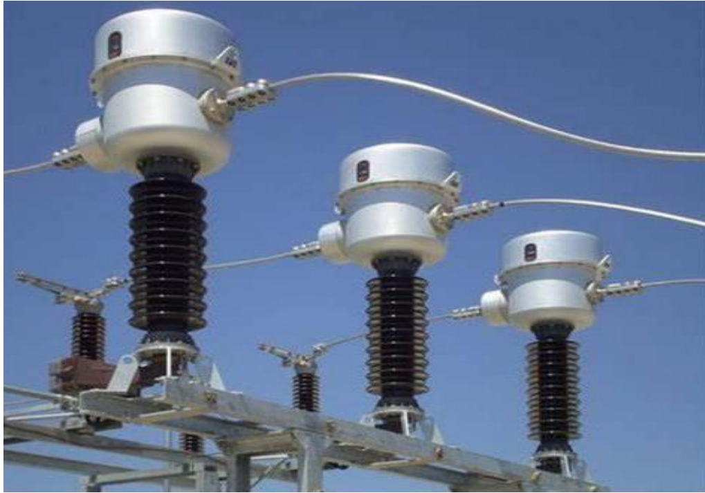
Slika 3.4. Strujni mjerni transformator montiran na potpornom izolatoru [6]
