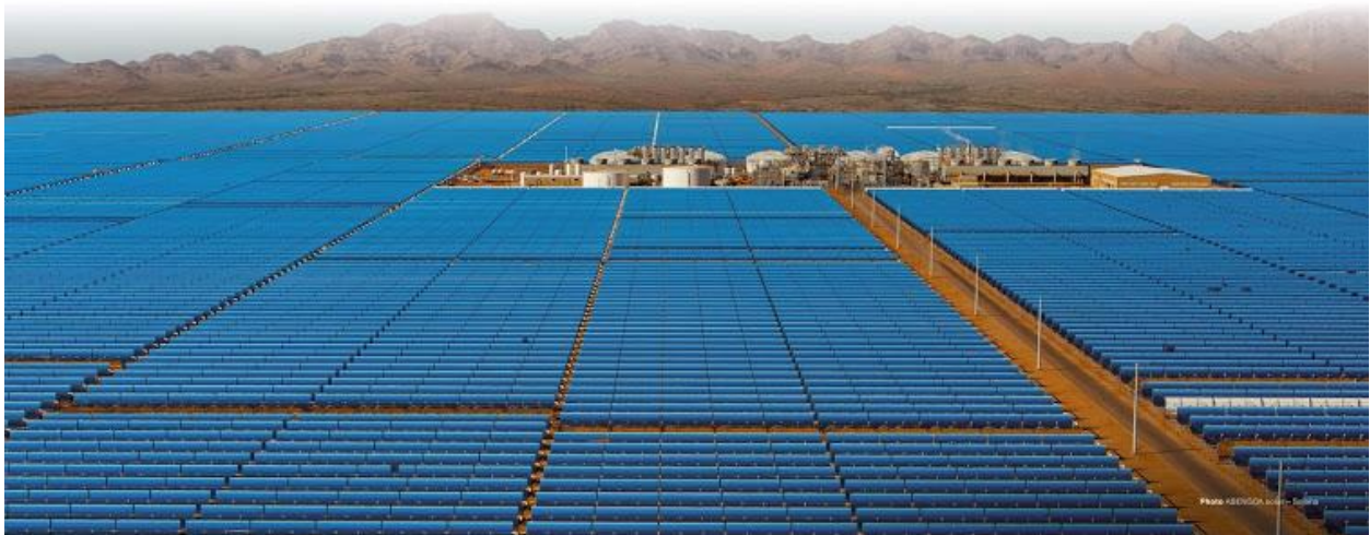
Sl. 4.5. Slika solarne termoelektrane SOLANA u Arizoni[13].
