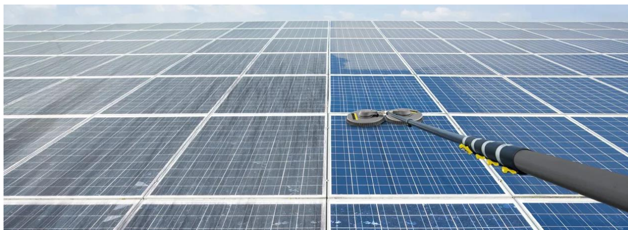
Slika 4.3.1. Održavanje solarnih panela [16]
