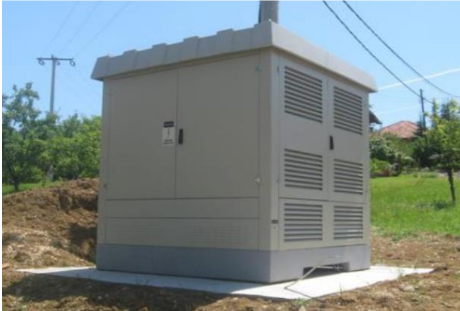
Slika 3.5. Primjer kućišta trafostanice [19]
