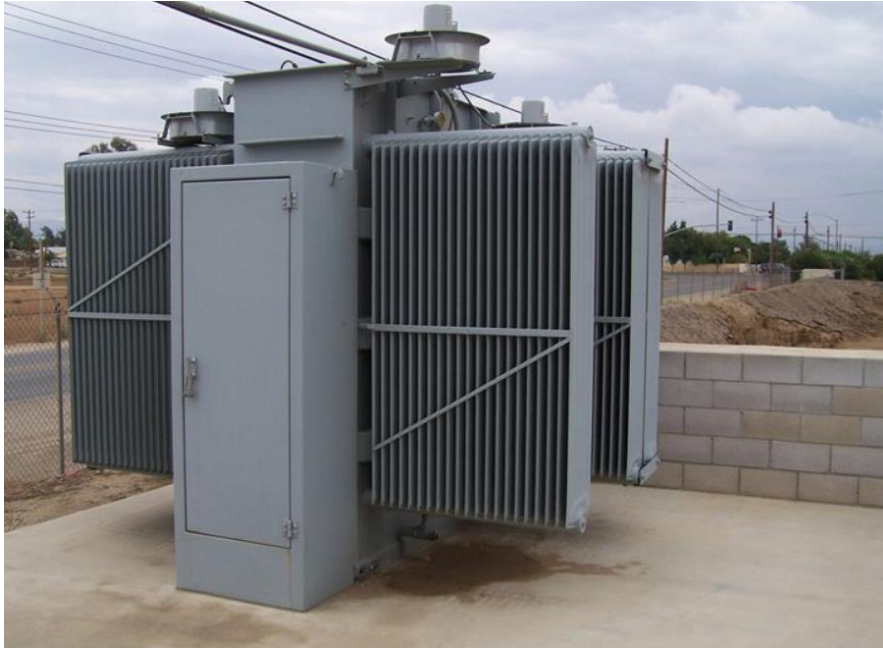
Slika 3.6. Curenje transformatorskog ulja [37]
