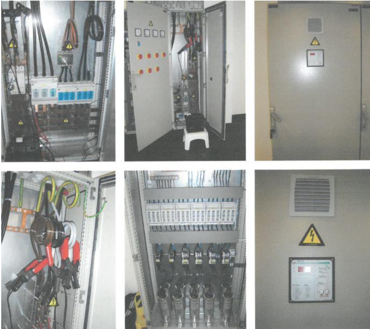
Slika 4.8. Postupak mjerenja elektroenergetski veličina na razvodnim ormarima [6]
