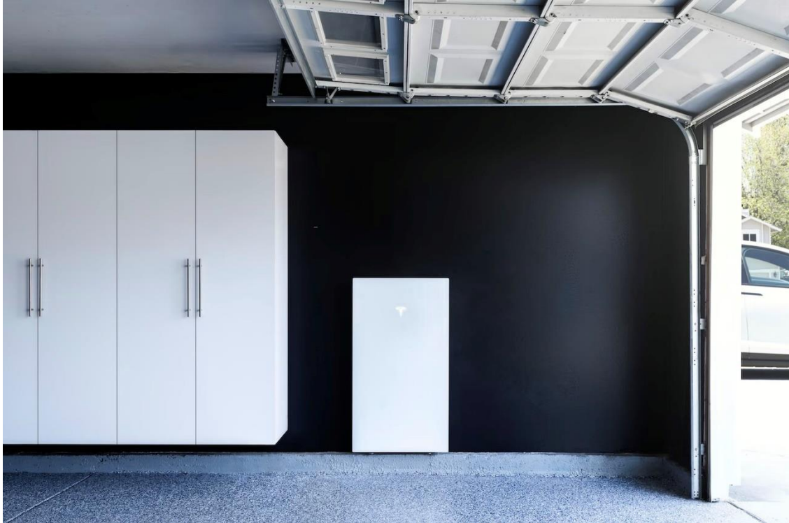
Slika 4.3. Prikaz Tesla Powerwall 3 baterijskog sustava pohrane [33]
