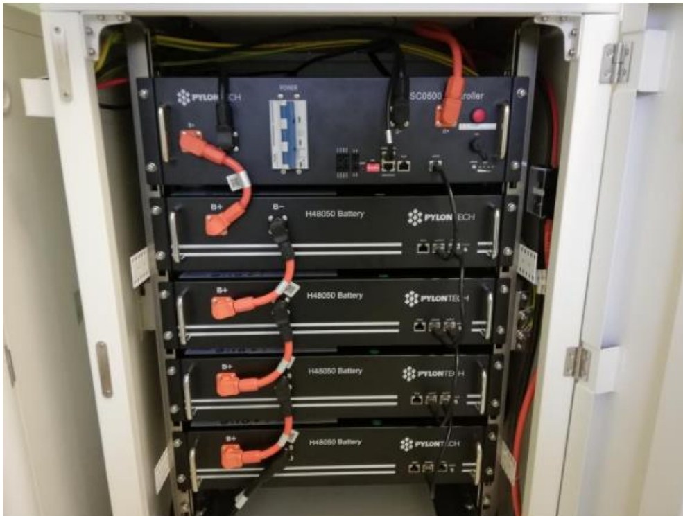
Slika 2.25. LiFePo4 baterije Pylontech H48050 u Laboratoriju za OIE FERIT-a, [14]
