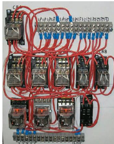
SI. 3.1. Relejni kontrolni panel [4]
