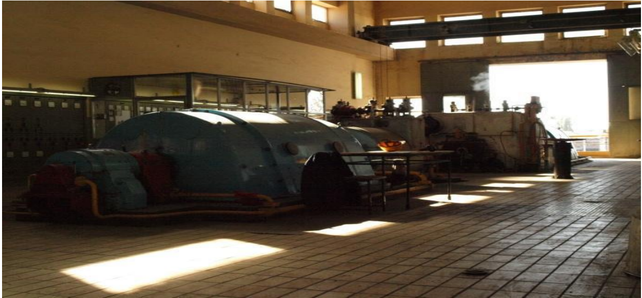
Slika 4.3. Generator Rade Končar 2,5 MW
