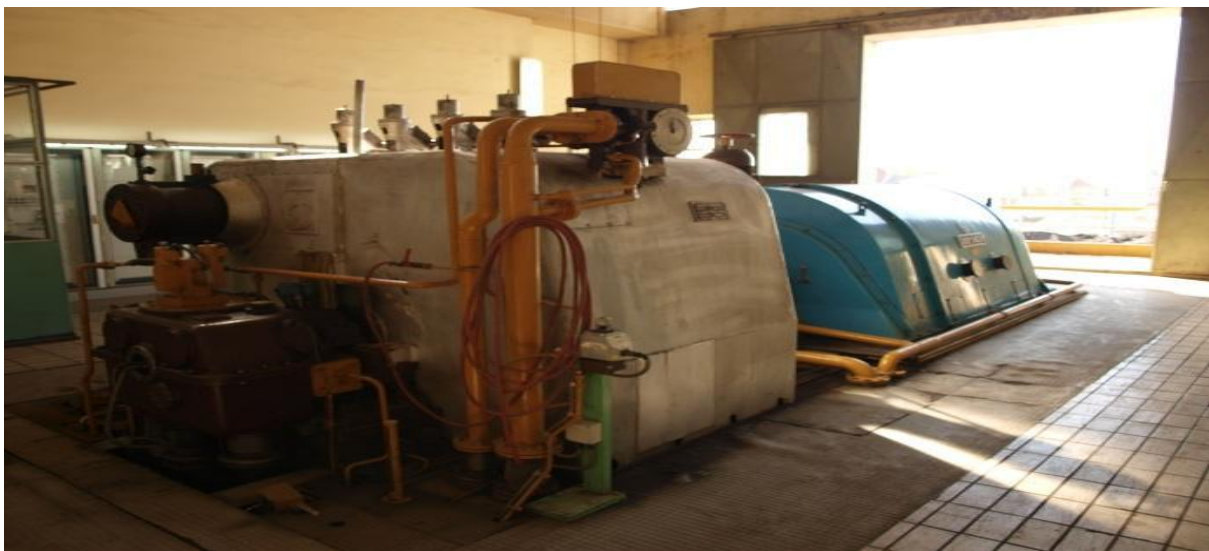
Slika 3.7. Turbina 10 MW u Tvornici šećera Osijek
