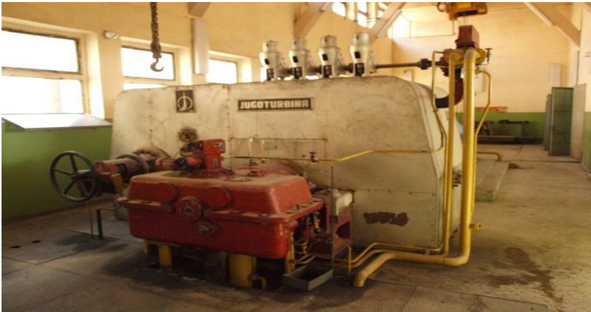
Slika 3.4. Turbina 6 MW u Tvornici šećera Osijek
