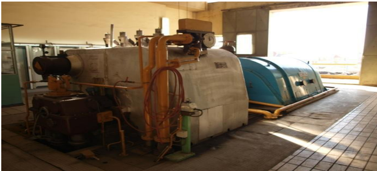
Slika 3.7. Turbina 10 MW u Tvornici šećera Osijek
