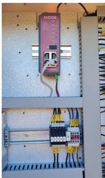
Slika 5-7 Primjer ugradnje GPRS-a u upravljački ormarić
