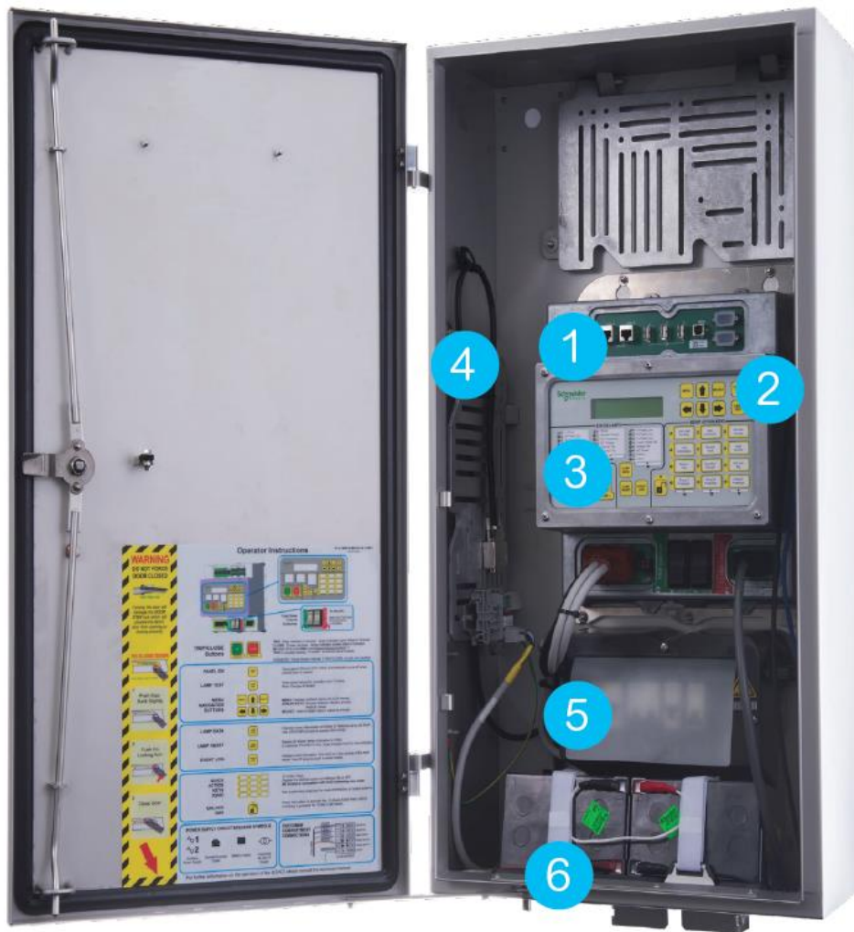
Slika 3-14 PowerLogic AVDC ULTRA ormarić [6]
