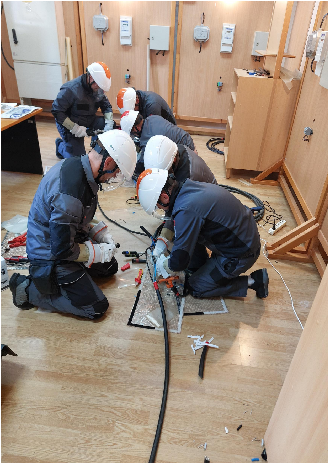
Slika 4.7 Metoda rada „uz dodir“, praktični primjer na kabelu u HEP NOC Velika
