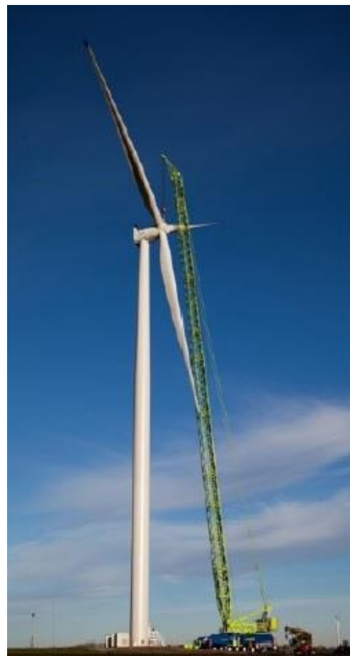
Sl.4.1. Vjetroagregat SWT 3.0- 101.
