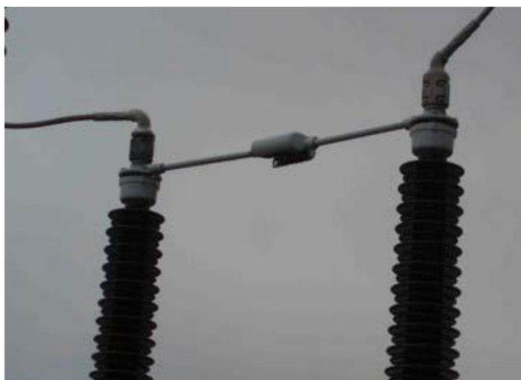
Slika 4.4.9. Termogram visokonaponskog rastavljača u transformatorskom polju [5]
