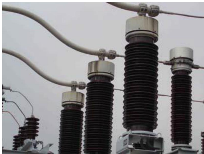
Slika 4.4.5. Termogram naponskih mjernih transformatora u transformatorskom polju [5]
