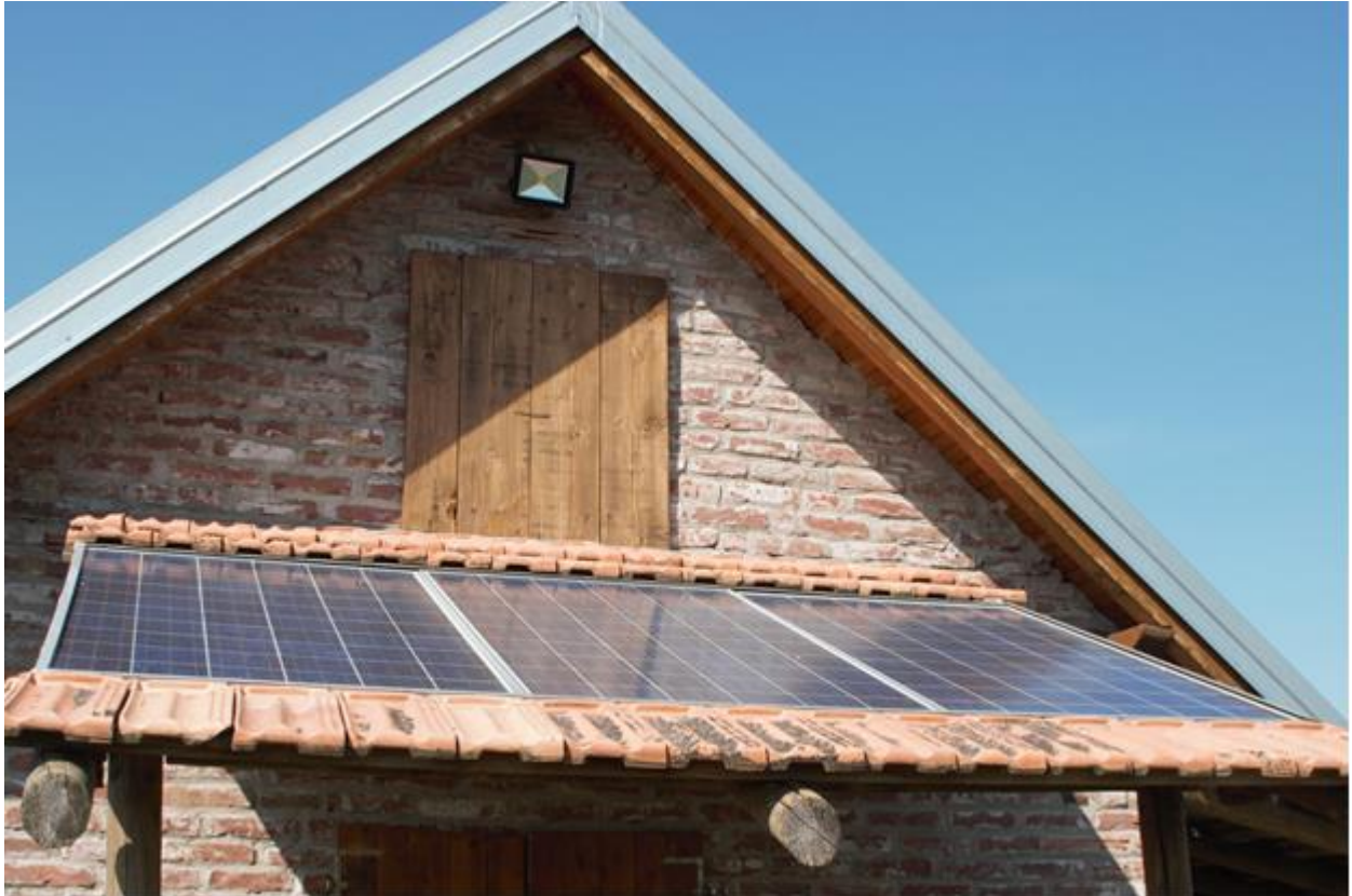
Sl. 3.1. Fotonaponski moduli u okolici Osijeka.
