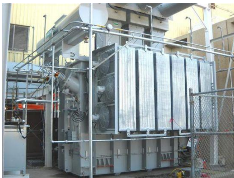
Slika 3.8. Trofazni transformator sa snagom 100 MVA
