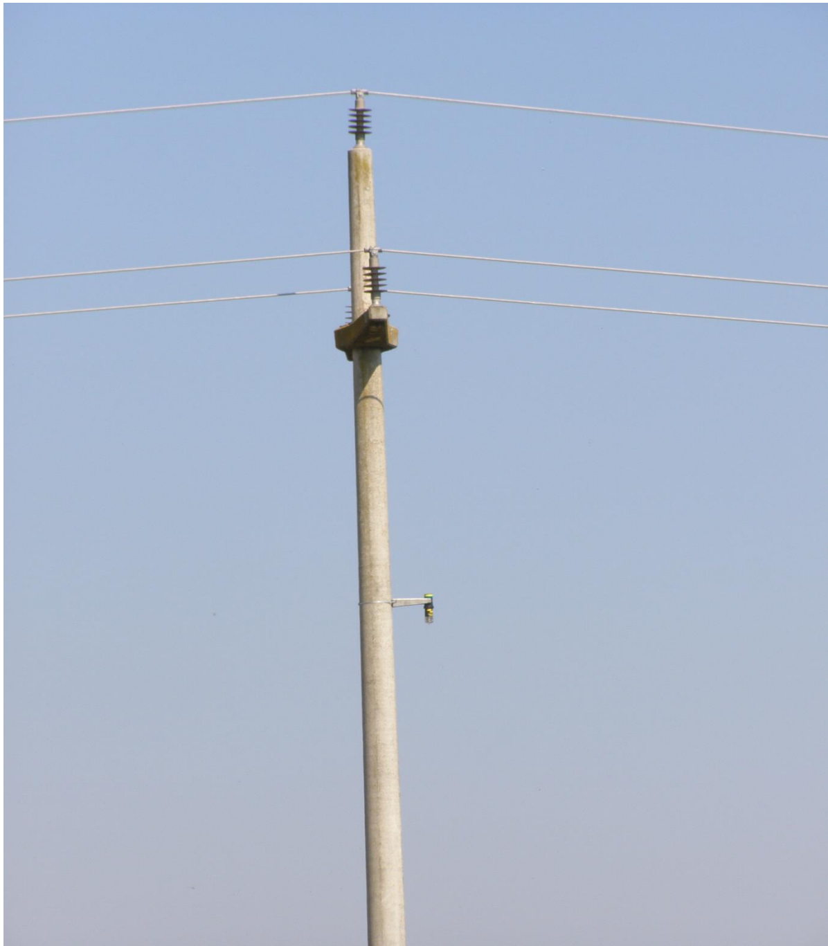
Slika 2.6. LineTroll indikator montiran na stup ispod vodiča [11]
