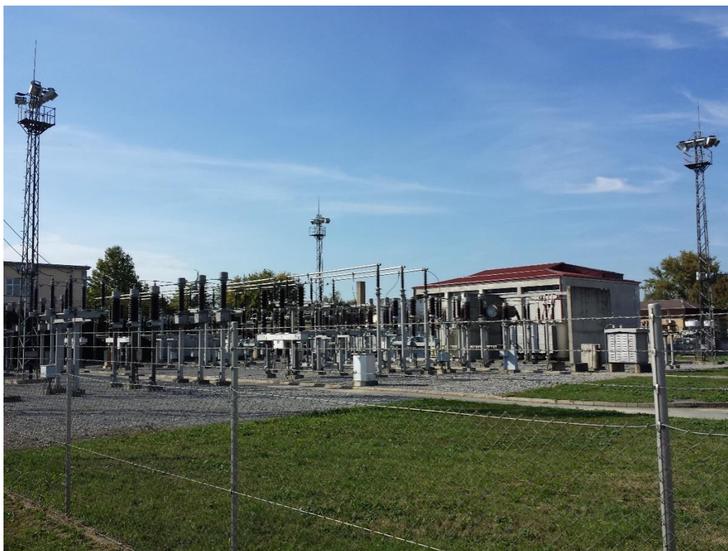
Slika 2.2. Prikaz tipične trafostanice
