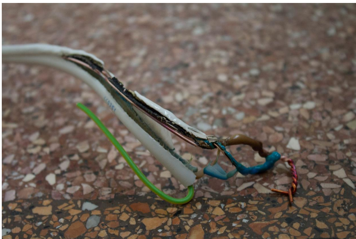
Slika 7.9. Vidno oštećena izolacija vodiča na kraju mjerenja
