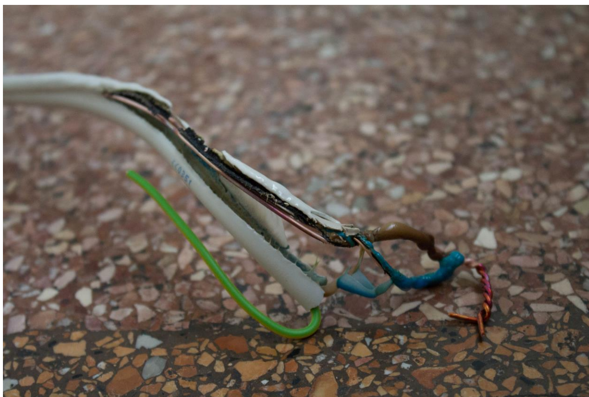
Slika 7.9. Vidno oštećena izolacija vodiča na kraju mjerenja
