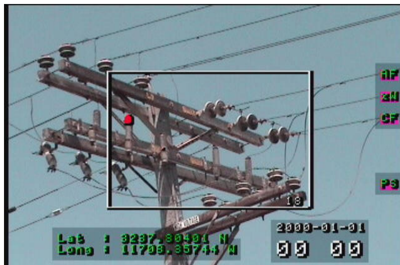
Slika 8.4. Prikaz dalekovoda UV kamerom u vidljivim bojama
