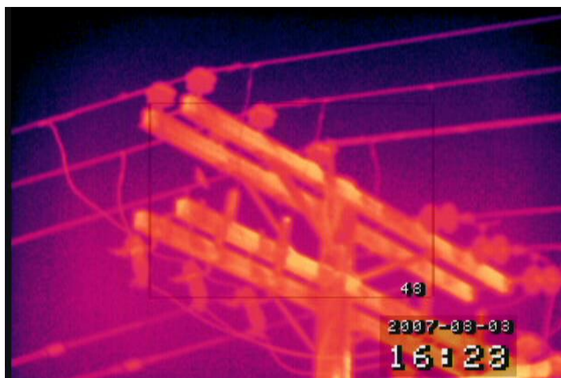
Slika 8.5. Prikaz dalekovoda infracrvenom kamerom u infracrvenim bojama
