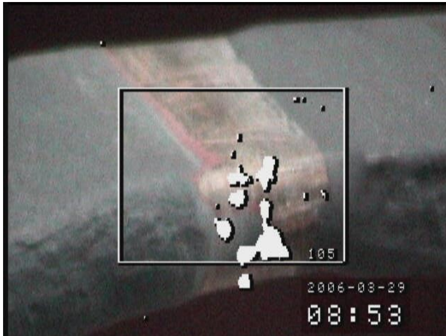
Slika 8.10. Pojava korone na sabirnicama generatora
