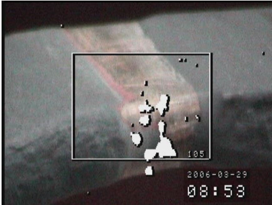
Slika 8.10. Pojava korone na sabirnicama generatora
