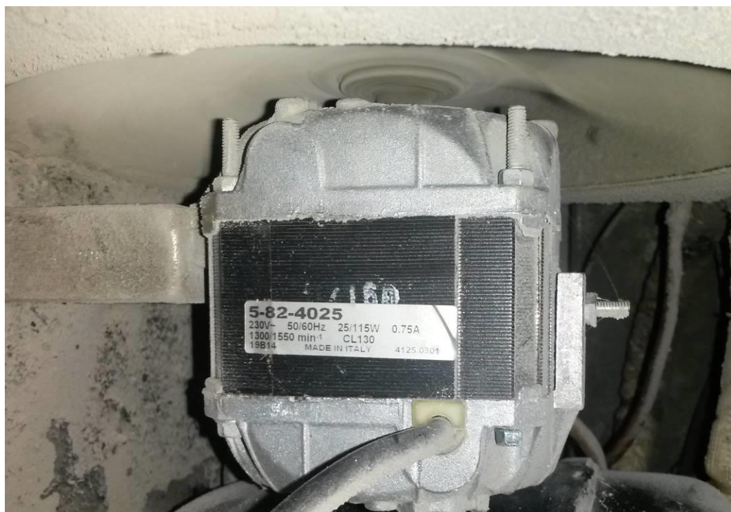
Slika 4.8. EMI motor koji pogoni ventilator
